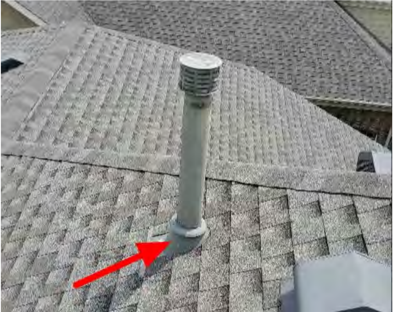
6 Furnace vent boot D&R
